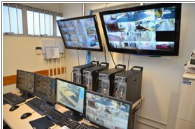
Central de monitoramento do Foro
