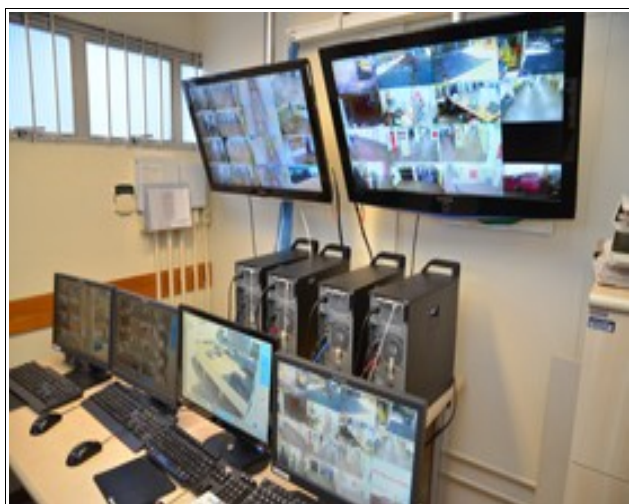
Central de monitoramento do Foro
