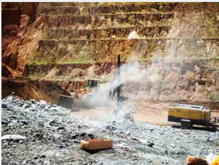
Foto de situação de grave e iminente risco com atividades de perfuração concomitantes com carregamento de explosivos. Fonte: Arquivo do autor
