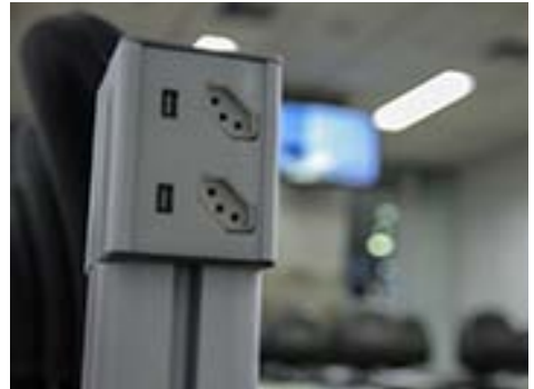
Totem para carregamento de baterias de aparelhos eletrônicos instalado pelo TRT2 para usuários de suas unidades
